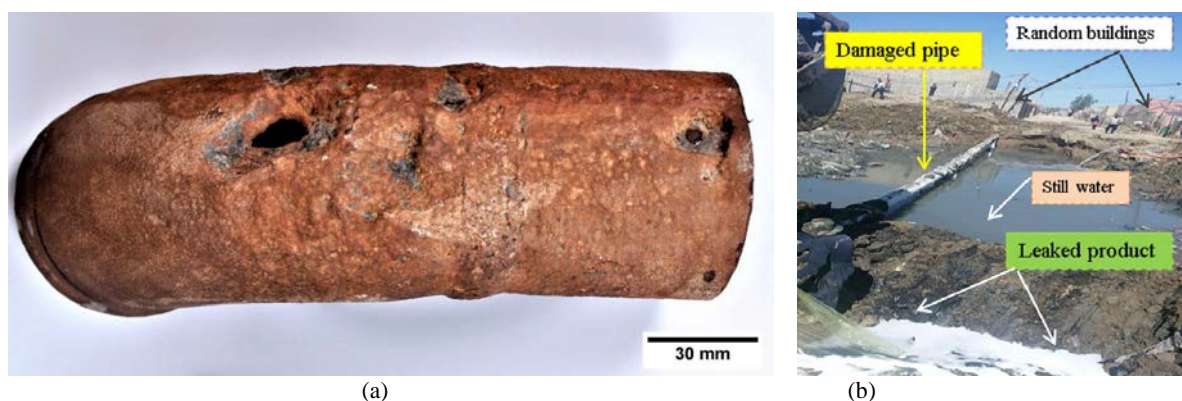
Gambar 2. Kerusakan akibat SRB pada saluran pipa di : (a) industri petrokimia [24], (b) industri minyak bumi (kanan) [22]
