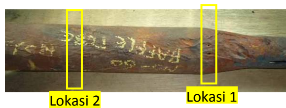
Gambar 4. Permukaan pipa baffle menunjukkan adanya lubang
