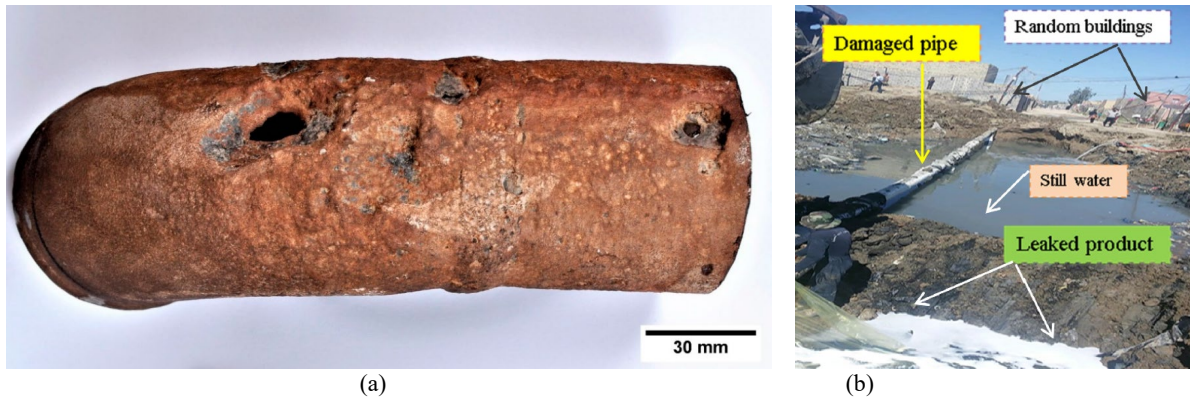
Gambar 2. Kerusakan akibat SRB pada saluran pipa di ; (a) industri petrokimia [24], (b) industri minyak bumi (kanan) [22]
