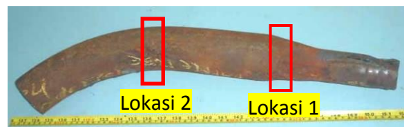
Gambar 2. Gambar pipa baffle yang rusak pada heat exchanger memperlihatkan adanya lubang akibat serangan korosi-erosi
